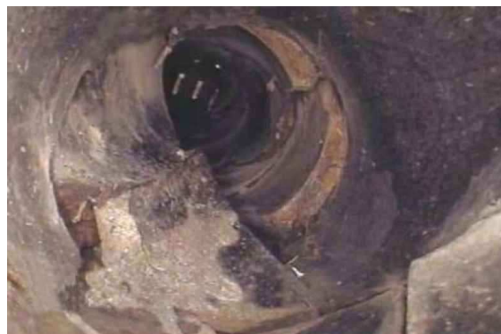
Figure 7 : Sans un entretien approprié des canalisations existantes, les nappes phréatiques pourraient également être polluées par des infiltrations d'eaux usées en Suisse.
